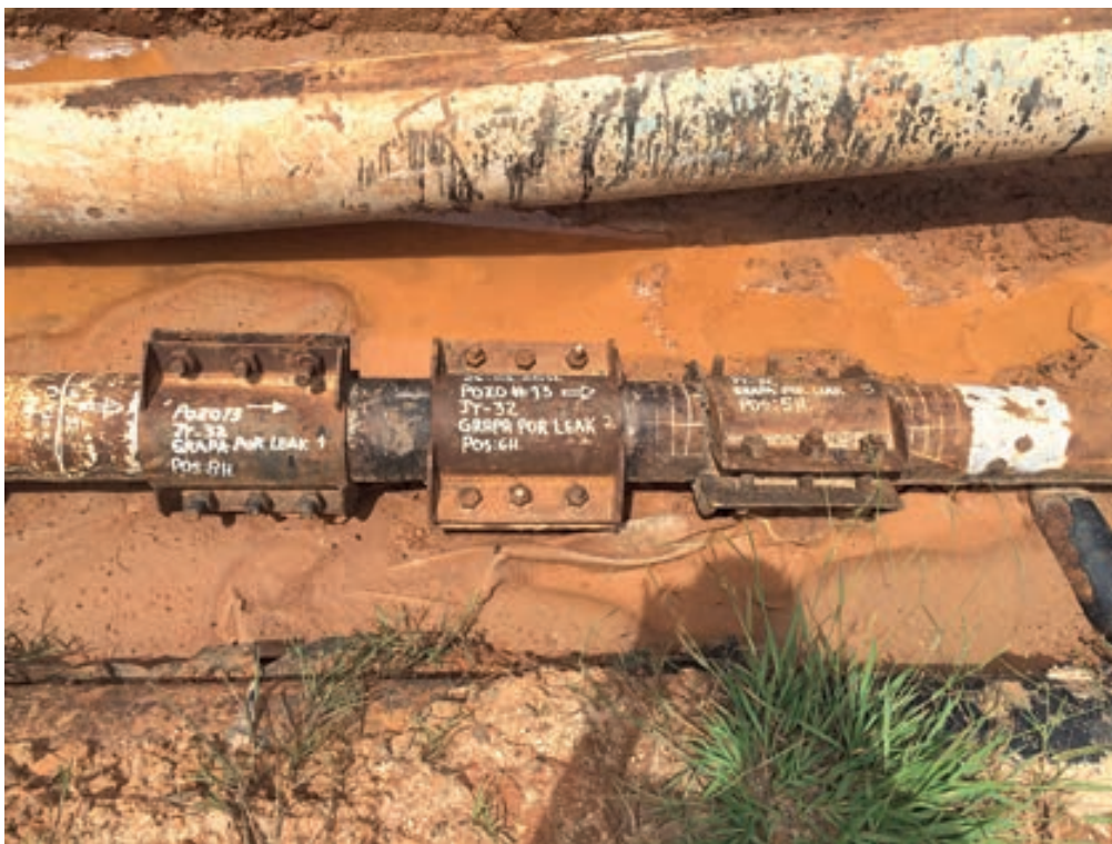
Grapas en los ductos por causa de derrame.
